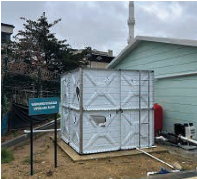
Yağmur Suyu Hasadı Uygulama Alanı
