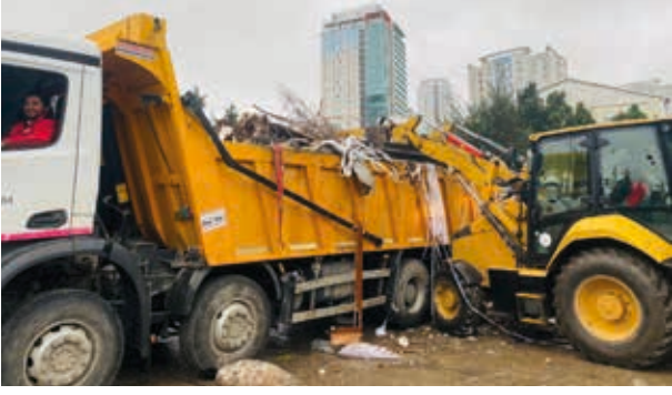
Hafriyat Toprağı İle İnşaat Yıkıntı Atıklarının Toplanması ve Ruhsatlı Döküm Sahasına Taşınması
