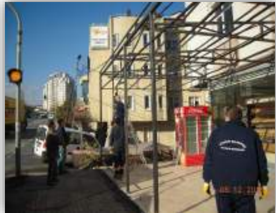
Atatürk Mahallesi. Dudulu Cad.Kaçak Yapılaşmaya Müdahale
