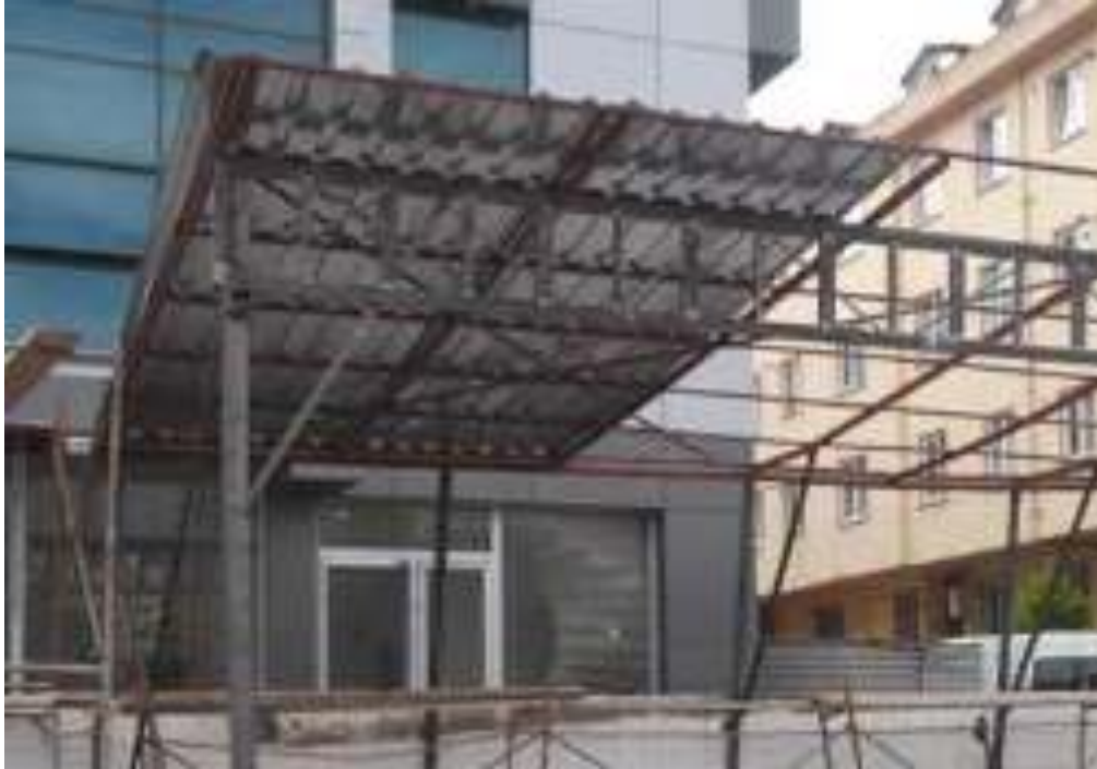
Kayışdağı Mahallesi'nde yapılmış olan kaçak yapıya ekiplerimizce müdahale edilmesi
